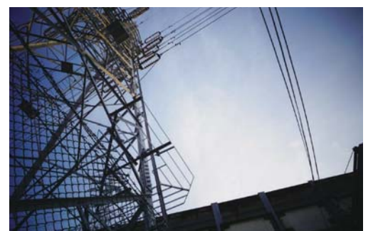
戸塚変電所付近(撮影: 鈴木 真帆)
