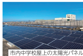
市内中学校屋上の太陽光パネル
