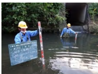
河道内の洗掘
