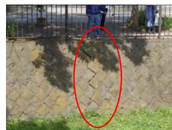
護岸のひび割れ
