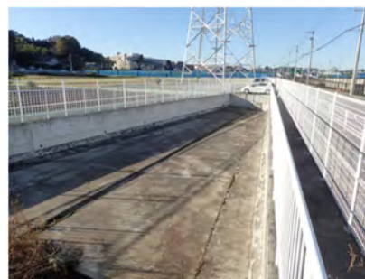
雨水流出抑制施設 (緑区 北八朔地区雨水調整池)
