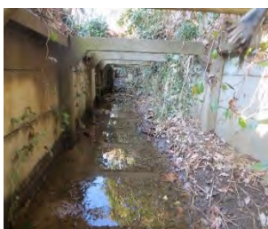
土砂堆積・植生繁茂
