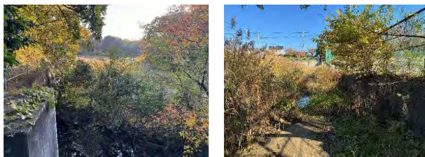
図 2-1 貯留機能が低下している施設
