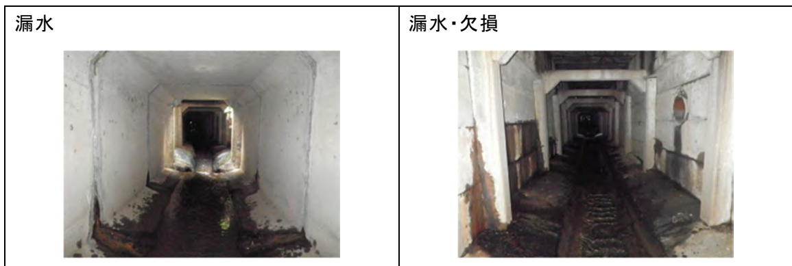
図 2-4 暗きよの変状例
