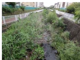
河道内の植生繁茂
