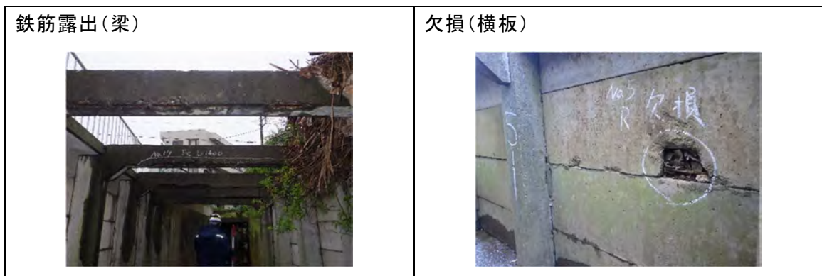
図 2-3 柵きよの変状例
