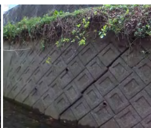
護岸ひび割れ・はらみだし
