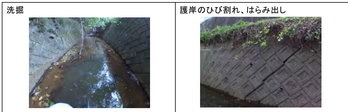
図 2-2 護岸の変状例
