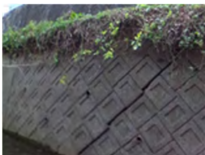
施設の変状(ひび割れ)
