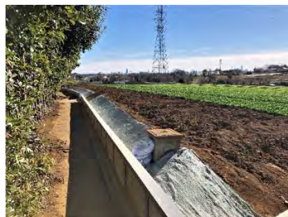
【土留め柵を設置した農地】（都筑区）
