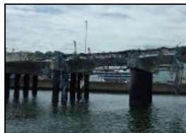
南本牧はま道路の損傷（中区）
