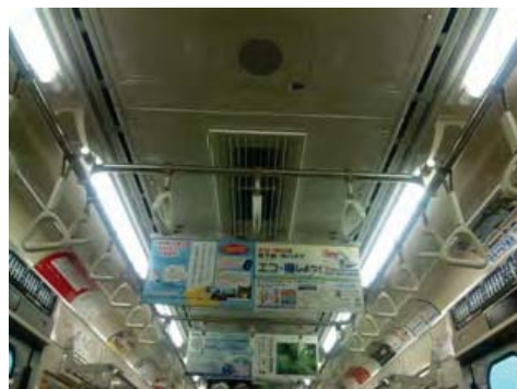
【LED化した地下鉄車内の照明】
