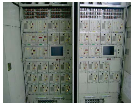
【更新後のATC装置】
