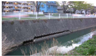
河川護岸の崩壊
