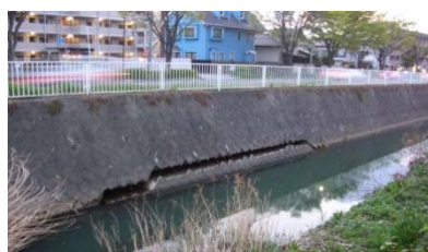
河川護岸の崩壊
