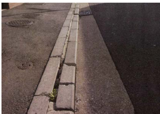
縁石の破損 （南区井土ヶ谷中町）
