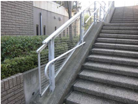
階段手すりが脱落 うけぢ (請地歩道橋・都筑区)
