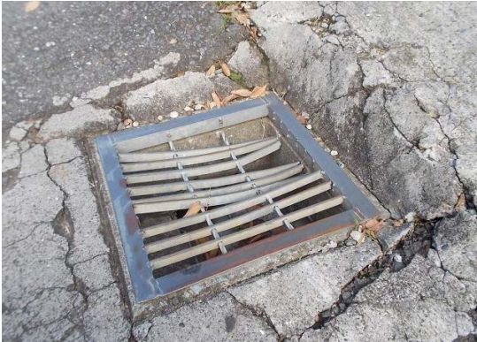
グレーチング柵の破損 （保土ヶ谷区新井町）
