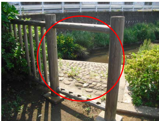
転落防止柵の縦格子抜け (砂田川・港北区)
