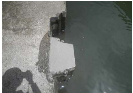
応急対応実施後 (根継ぎ矢板背面をコンクリート充填済み)
