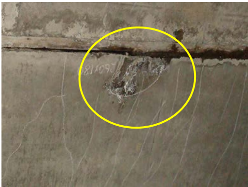
天井部コンクリートのはく離 (入之谷第1 隧道・保土ヶ谷区)
