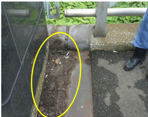
伸縮装置の腐食 (布袋橋・神奈川区)
