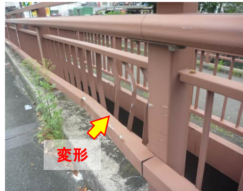
高欄の変形 (旭橋・中区)
