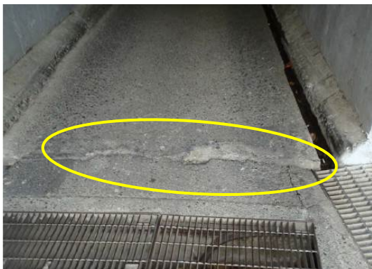
舗装の段差 (上矢部地下道・戸塚区)
