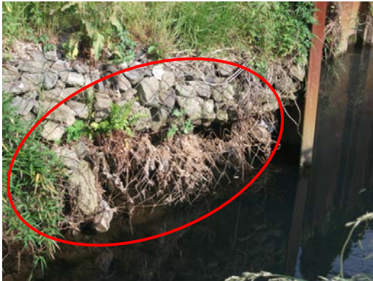
護岸等の補修 (蛇かごの石流出) (舞岡川・戸塚区)
