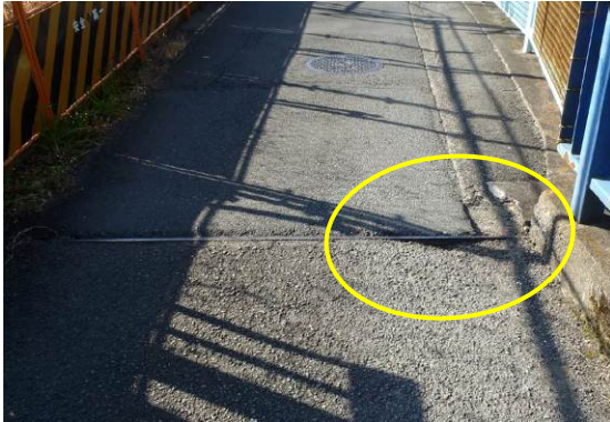
橋梁端部の段差 (舞岡橋・戸塚区)
