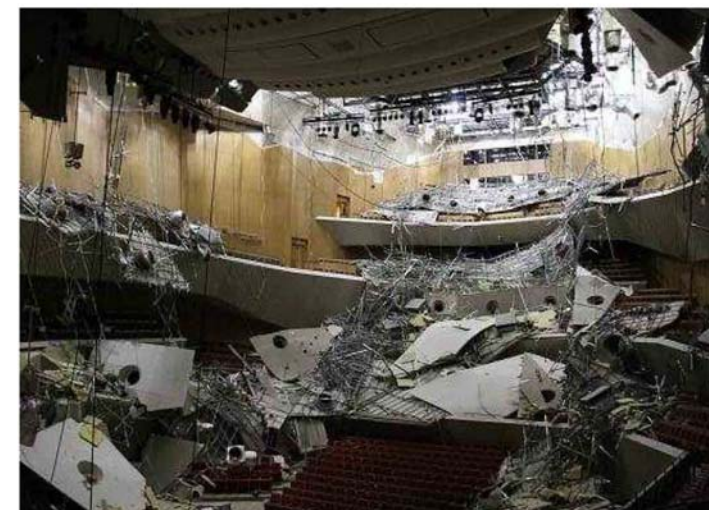
音楽ホールにおける天井の脱落 (ミュージザ川崎シンフォニーホール)
