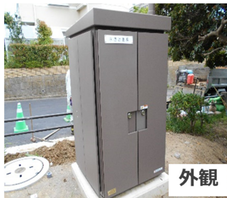
水道計測設備の写真
