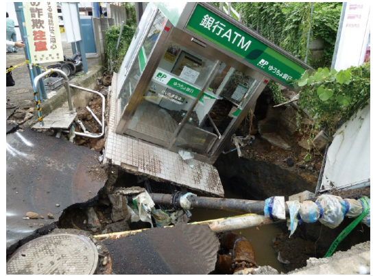
井土ヶ谷駅付近での漏水事故
