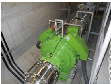
今井配水池の 小水力発電設備
