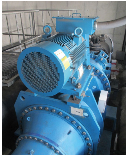
川井浄水場の小水力発電設備
