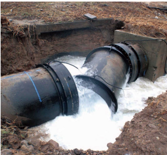
東日本大震災で外れた水道管のつなぎ目（宮城県企業局提供）
