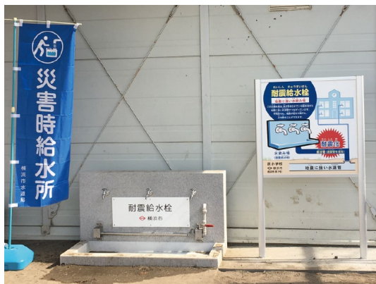
災害時給水所ののぼりと耐震給水栓
