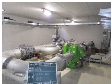
恩田配水池の 小水力発電設備
