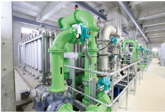
川井浄水場の膜処理設備
