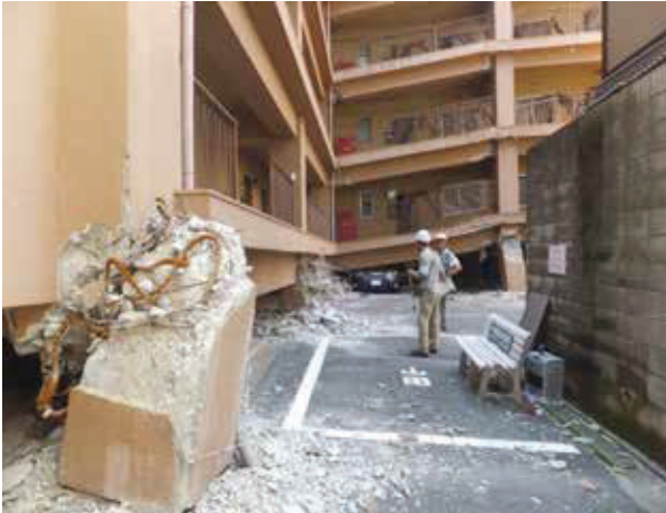
柱の座屈が起きて、ピロティ層が崩壊したマンション。 編集協力者撮影
