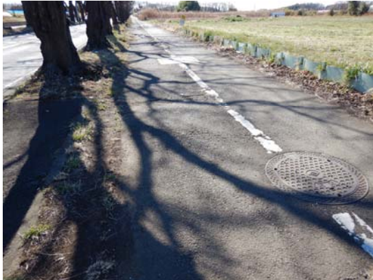
植栽基盤が狭く、歩道側へ根系が伸長し、舗装面を持ち上げ、歩行へ支障が生じている。
