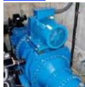
「水道局 川井浄水場発電設備」
