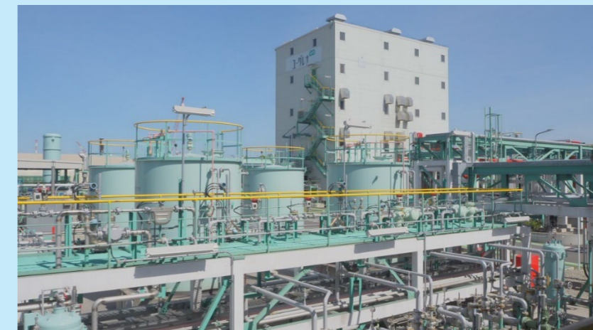
バイオ燃料製造実証プラント
