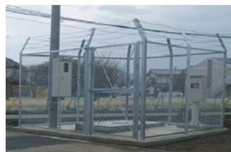
【写真】井戸施設(緑区)
