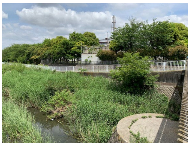
図 1-29 平戸永谷川の樹木繁茂状況
