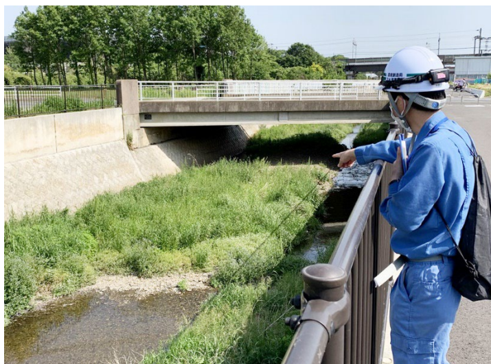
図 8-1 河道内の土砂堆積状況
