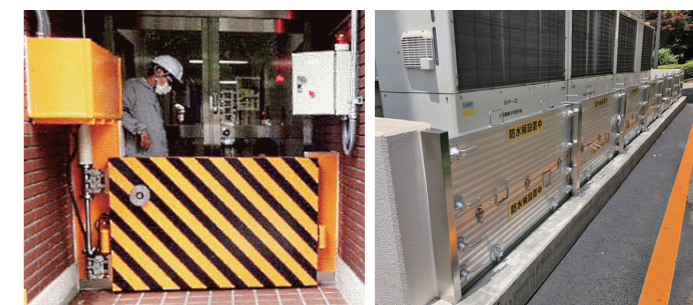
建物の耐水化（防水扉）
