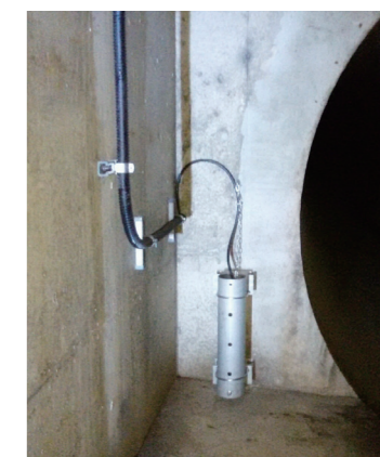
水位計設置状況
