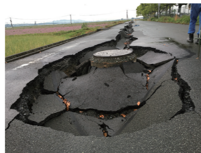
2016（平成28）年 熊本地震被害状況（下水道管）
