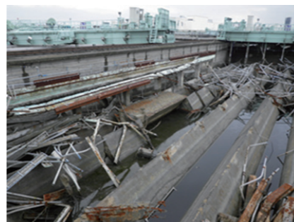
2011（平成23）年 東日本大震災被害状況（施設）
