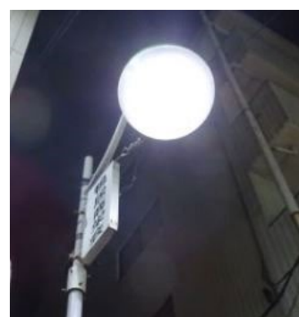
LED照明を設置した街路灯 (鴨居商栄会(緑区))
