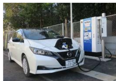
急速充電設備(資源循環局都筑工場)
