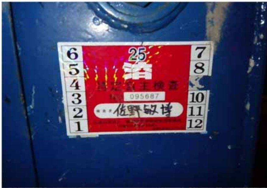
写真 2.5.4-4 環境保全のための実施状況（定期点検・整備）
