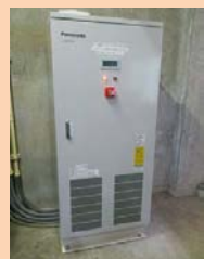
蓄電池の設置
