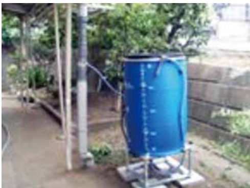
▲雨水貯留タンク
