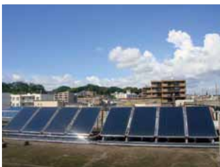
▲屋上に設置した16m 2 の集熱パネル
