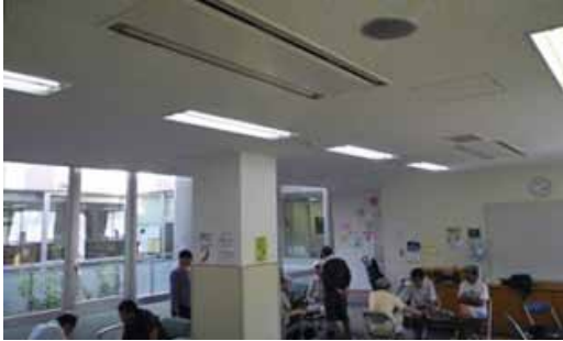
▲ LED 照明に交換した区民利用施設
