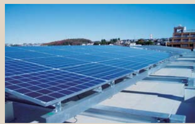
▲川和車両基地の太陽光発電装置
