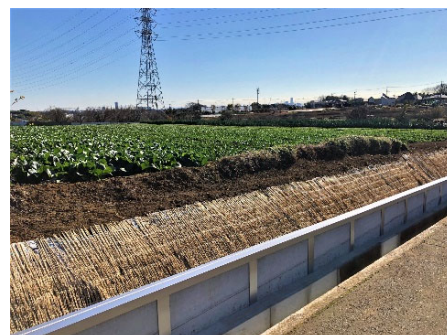
【土留め柵を設置した農地】（都筑区）
