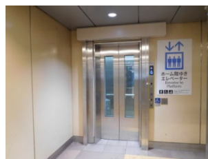
▲更新したエレベーター
