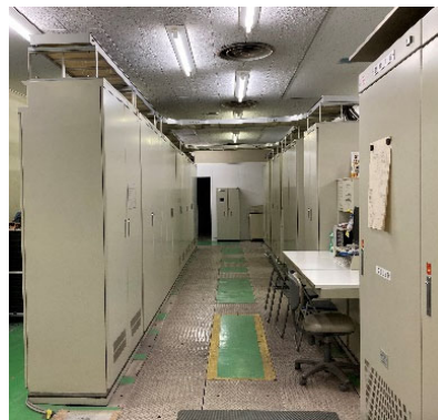
▲上永谷機器室全景
