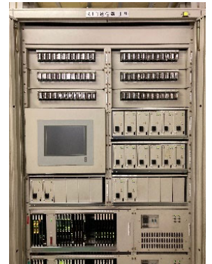
▲ユニット類（一例）
