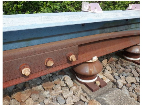
サードレールを支える罫子
