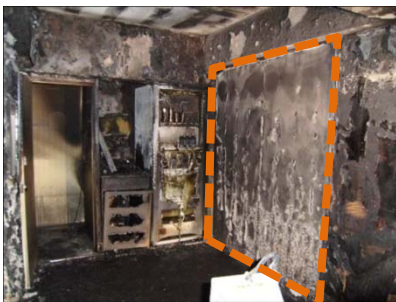
火災発生現場
