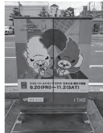
北新横浜駅周辺の地上電源機器装飾
