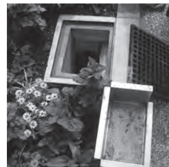
レインガーデン取込口 (上) 歩道側 (下) 車道側
