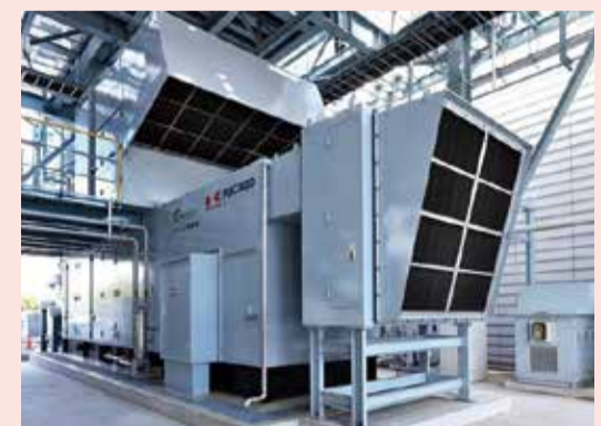
横浜磯子事業場に導入したコージェネレーションシステム
