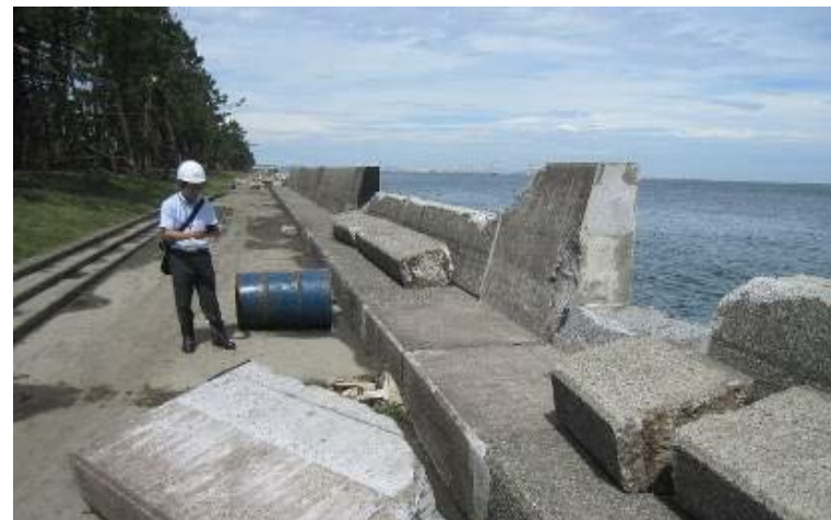
令和元年台風第15号による護岸の倒壊
