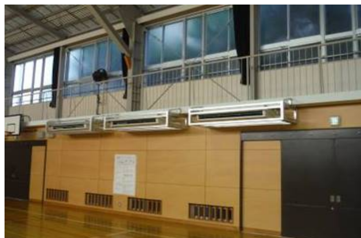
空調設備が設置された小学校体育館
