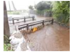
(未改修河川の浸水状況)
