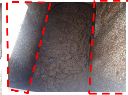
写真2 最終沈殿池流入水路 躯体劣化(骨材露出)
