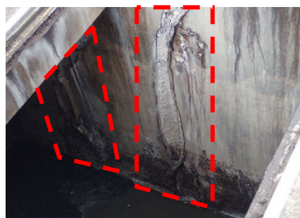
写真1 反応タンク流入水路 防食塗装剥離、躯体劣化
