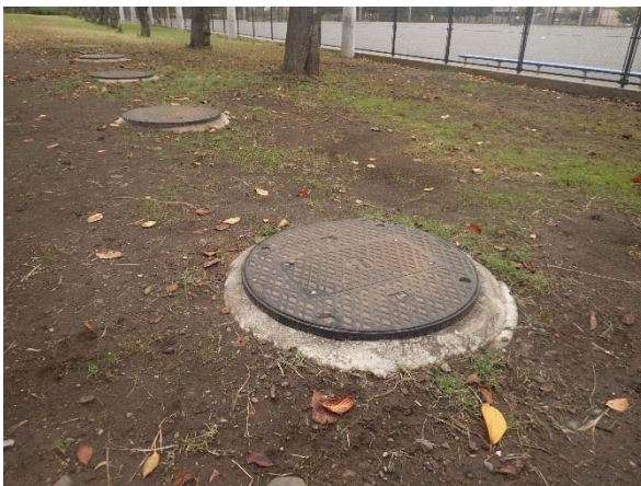
●マンホールトイレ
