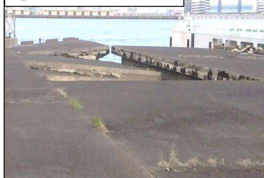
②9号岸壁(老朽化)
