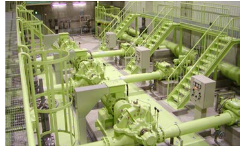
配水ポンプ (VVVF制御方式)
