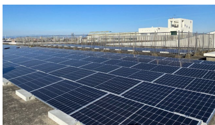
太陽光発電設備
