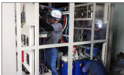
【本牧ふ頭B-1号上屋受変電設備更新】
