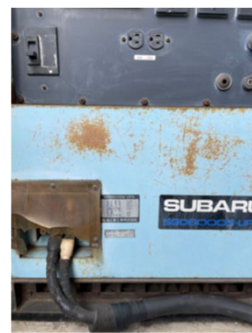
(写真：腐食状態)
