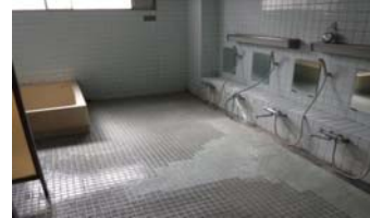
浴室 老朽化状況
