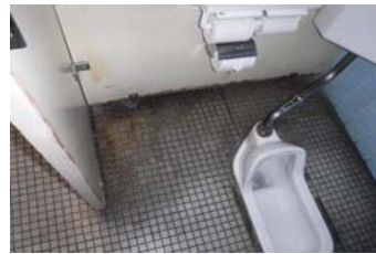
手洗所 老朽化状況
