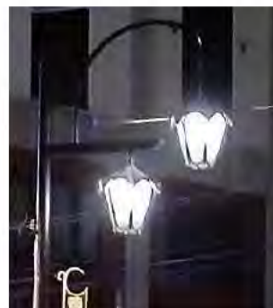
LEDランプ交換を行った 商店街街路灯 (3年度/鴨居商栄会)
