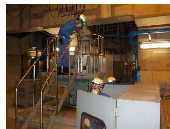
主ポンプ設備の維持管理
