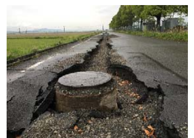
下水道施設の被害状況 平成28年熊本地震
