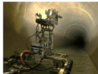
中大口径管用 TV カメラの例
