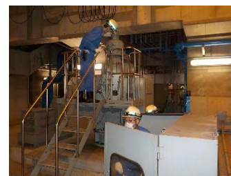
主ポンプ設備の維持管理
