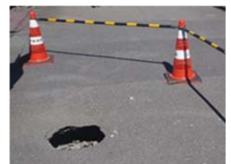
取付管破損による道路陥没
