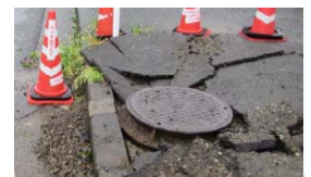
マンホール浮上被害状況
