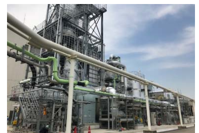
下水汚泥燃料化設備
