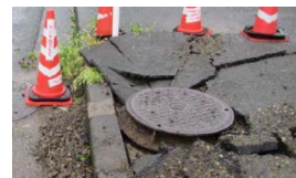
マンホール浮上被害状況
