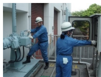
水処理設備の維持管理
