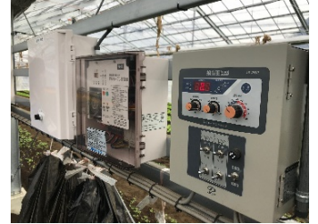
室温などを調整する制御盤(イメージ)
