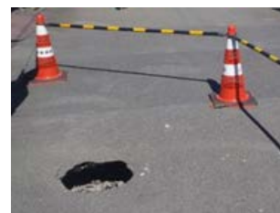
Zパイプ破損による道路陥没
