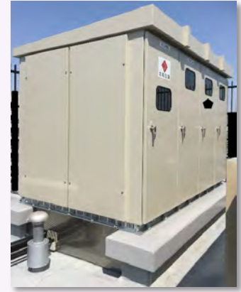
高圧一括受電の受変電設備
