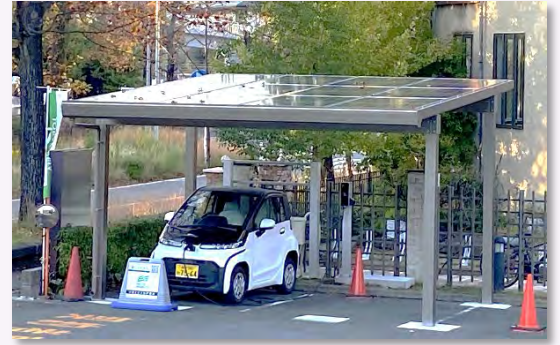
再エネ設備の導入 (たまプラーザ駅周辺地域)
