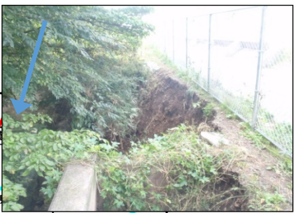
鉄道脇の河岸崩落 (JR東海道線、横須賀線)
