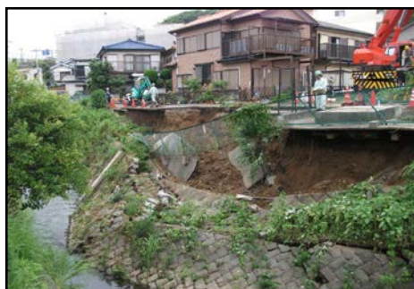
【老朽化による護岸崩落】（大岡川）
