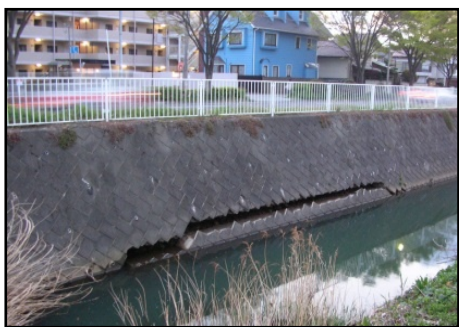
【老朽化による護岸崩落】 主要地方道環状 2 号線と並行する護岸（平戸永谷川）
