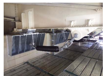
橋梁の耐震化(落橋防止装置の様子)
