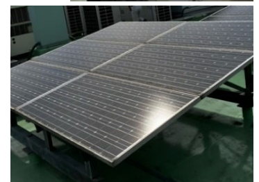
上：コンプレッサー 下：太陽光発電設備
