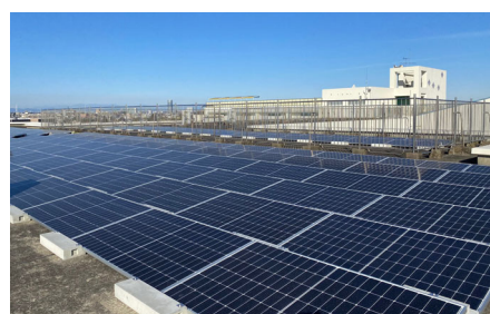
PPA 事業で設置した太陽光パネル
